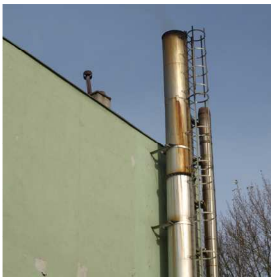
Fot. 3. Emitor kotła typu MKR 470
