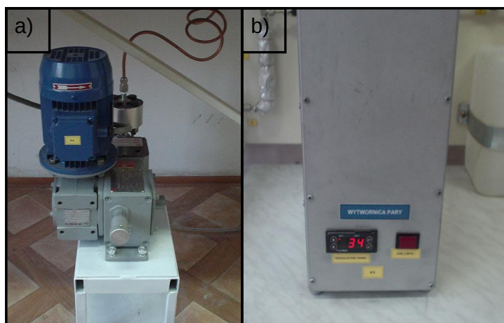
Fot. 2. Pompa wodna (a) wytwornica pary (b)
