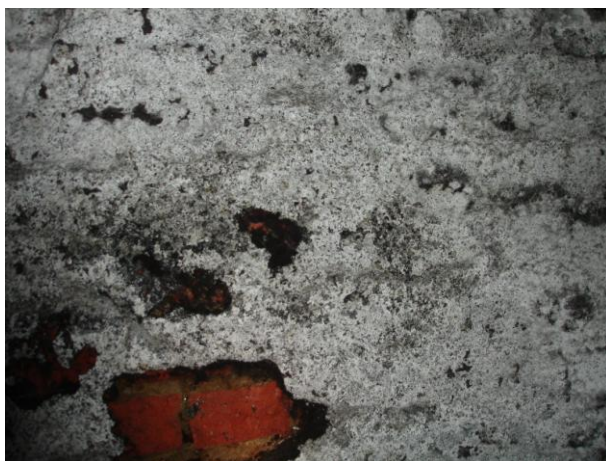
Fot. 9. Liczne naloty solne na obmurzu murowym z cegły
