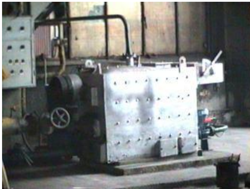
Fot. 2. Kocioł do spalania gazu procesowego
